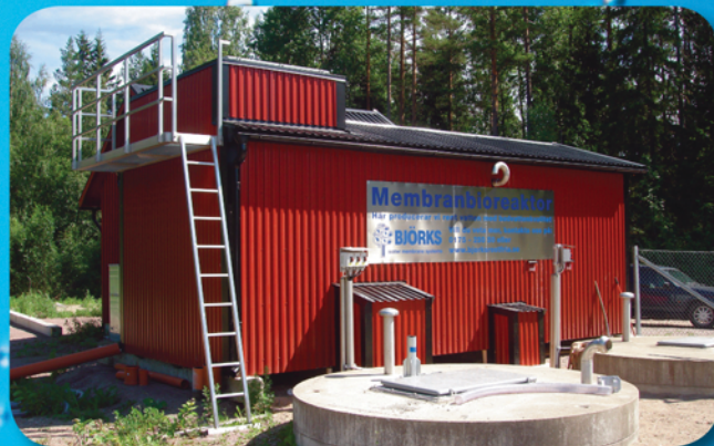
Driftsatt MBR-anläggning i Jäderfors.
